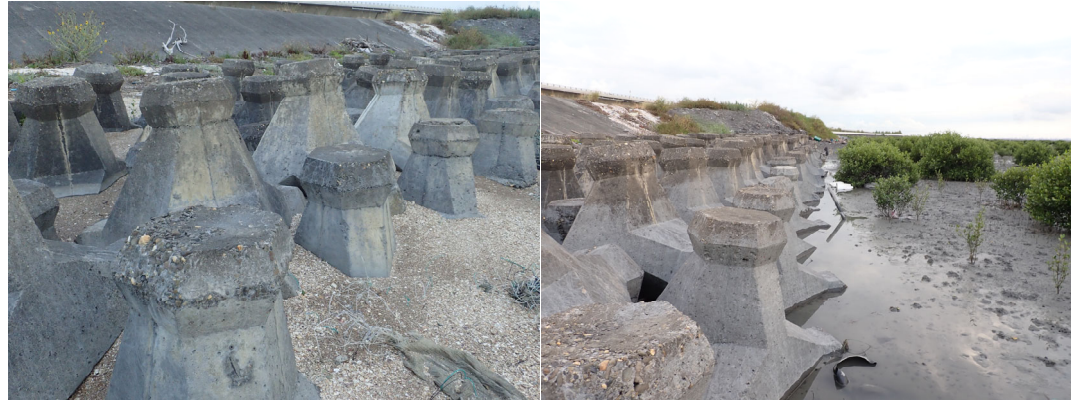
圖 56. 消波塊被泥沙與牡蠣殼覆蓋 (左圖)。部分消波塊座落於泥灘地的低窪處 (右圖)。
