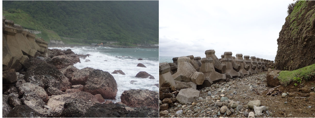
圖 112. 消波塊沿海岸投放，部分消波塊被礫石泥沙覆蓋，積淤嚴重（左、右圖）。
