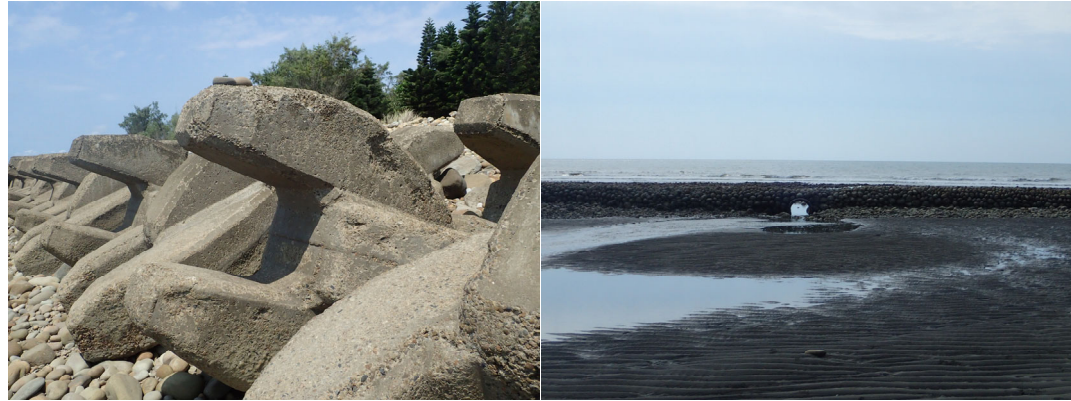
圖 36. 消波塊近照，可見其表面邊緣已有不平整的狀況 (左圖)。消波塊與海中間有利用礫石堆砌圍起的礫石堆牆 (右圖)。
