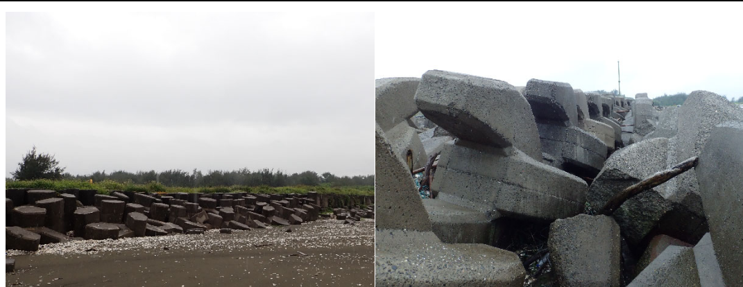
圖 68. 近岸處的消波塊明顯被土砂覆蓋，顯示此區淤積狀況嚴重 (左圖)。近海處投放天允塊，整齊堆放 (右圖)。
