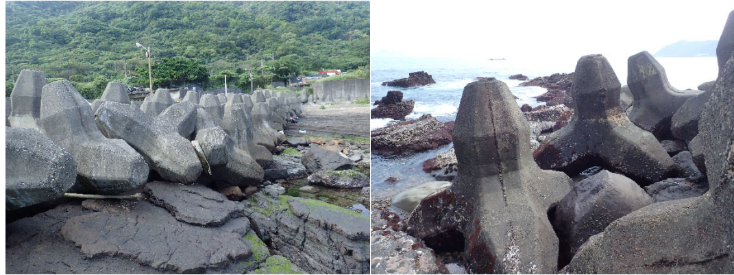
圖 32. 自天然岩岸方向 (近海處) 拍攝紀錄消波塊投放位置，可見低處有水渚 (左圖)。消波塊近照 (右圖)。
