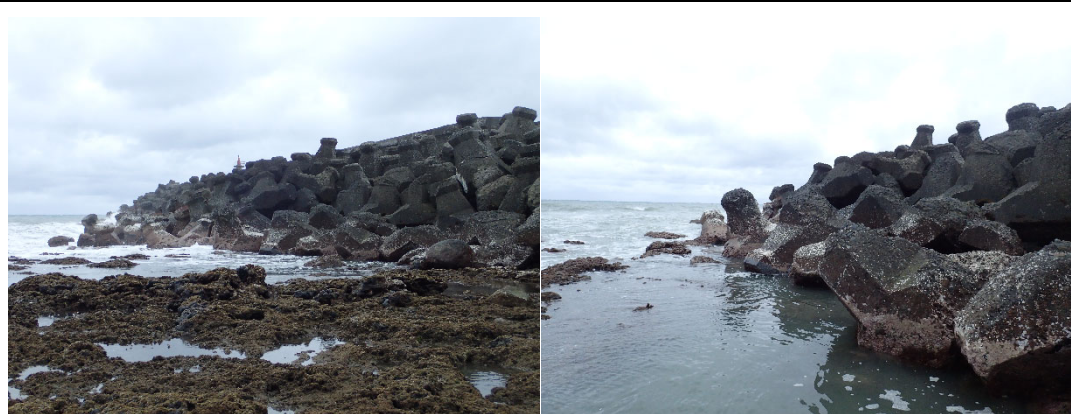
圖 124. 消波塊投放於海岸線上之狀況（右圖），堆放的協克塊底部於低潮時仍有部分淹沒於海水中（左圖）。
